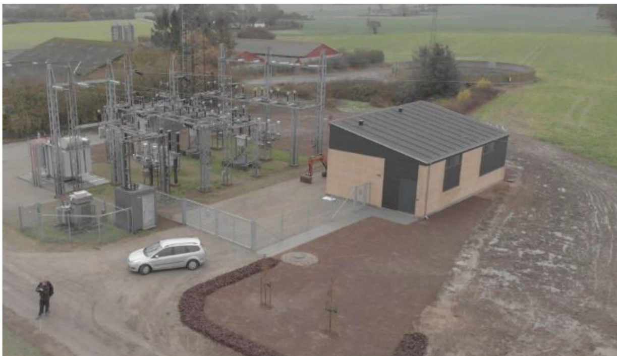
Eksempel på lignende transformerstation – nærværende projekt vil få samme udtryk
